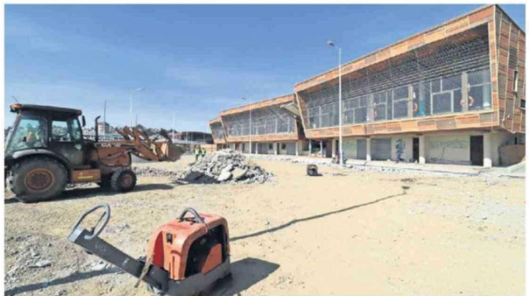
Las faenas buscan mejorar la funcionalidad de la infraestructura en el sector.
