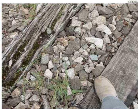
EN MALAS CONDICIONES ESTÁN LOS DURMIENTES.
