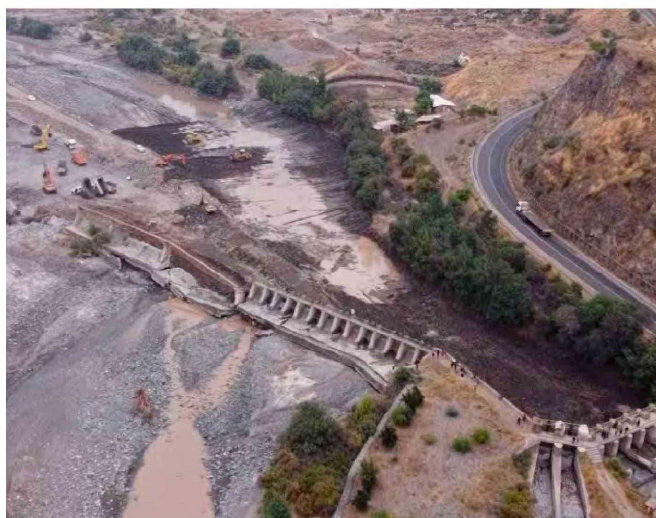
A fines de diciembre, la bocatoma de la Asociación de Canales de la Ribera Sur del Río Cachapoal, sufrió un derrumbe en su infraestructura poniendo en peligro la producción agrícola local debido a la falta de agua para el riego.
