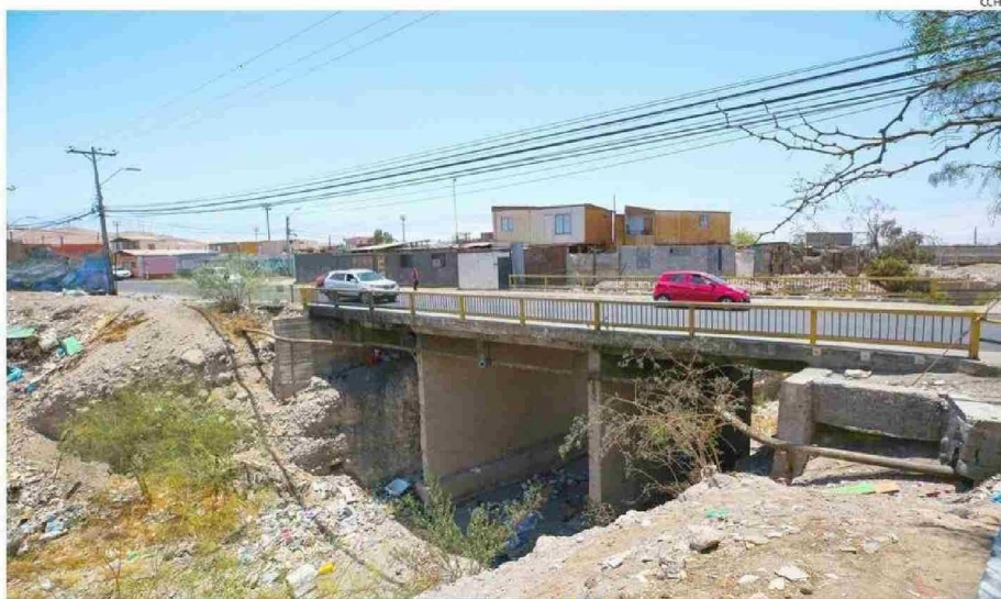
HACE AÑOS QUE ESTE PUENTE VIENE REGISTRANDO PROBLEMAS. DESDE LA CCHC VEN ESTE HECHO COMO MUY PREOCUPANTE.
