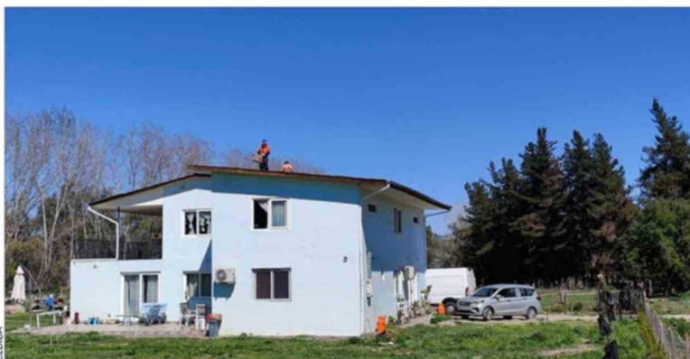
Los paneles solares ocupan todo el techo de la casa de Píruque.
