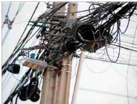
PLANES. — Algunos municipios han iniciado planes de despeje del cableado, con mesas técnicas con las compañías.
