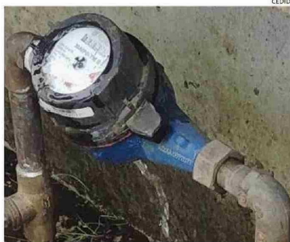
MEDIDOR ROTO POR LA ESCARCHA EN PULTAUACO.
