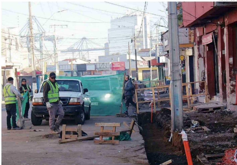
LA INICIATIVA CONSIDERABA UN PLAZO DE EJECUCIÓN DE 360 DÍAS POR PARTE DE LA EMPRESA A CARGO DE LAS OBRAS.
