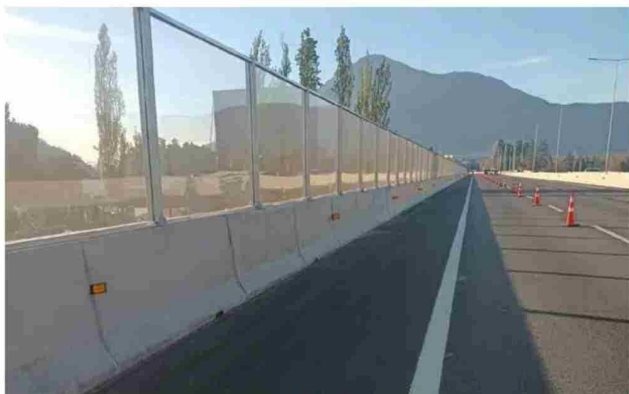
Barrera acústica reflectante instalada en Puente Peuco, Ruta del Maipo, Santiago-Talca.
