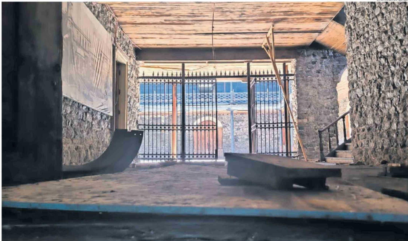
EL EDIFICIO SIGUE ESPERANDO POR SU RESTAURACIÓN, MIENTRAS EL PASO DE LOS AÑOS SIGUE DETERIORANDO SU FRONTIS Y LOS ESPACIOS EN SU INTERIOR.
