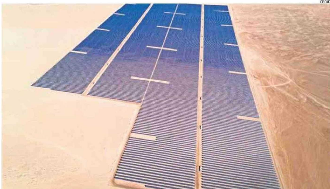
LA PLANTA FOTOVOLTAICA PAMPA SOLAR NORTE, QUE POSEE UNA CAPACIDAD DE 79 MW, ESTÁ OPERATIVA DESDE 2016 EN LA COMUNA DE TALTAL.
