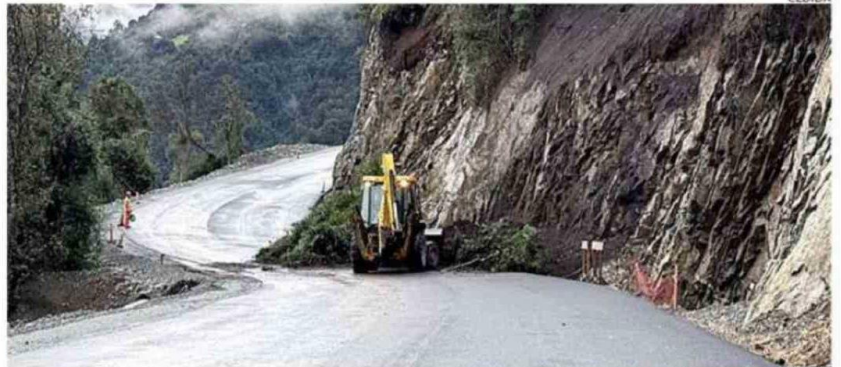
DIRIGENTES MANIFIESTAN QUE LA MANTENCIÓN NO HA SIDO LA ADECUADA Y SEÑALAN QUE URGE HACER ALGO.
