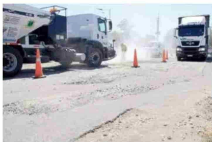
Camino a Tutuquén en mal estado, denuncian vecinos.
