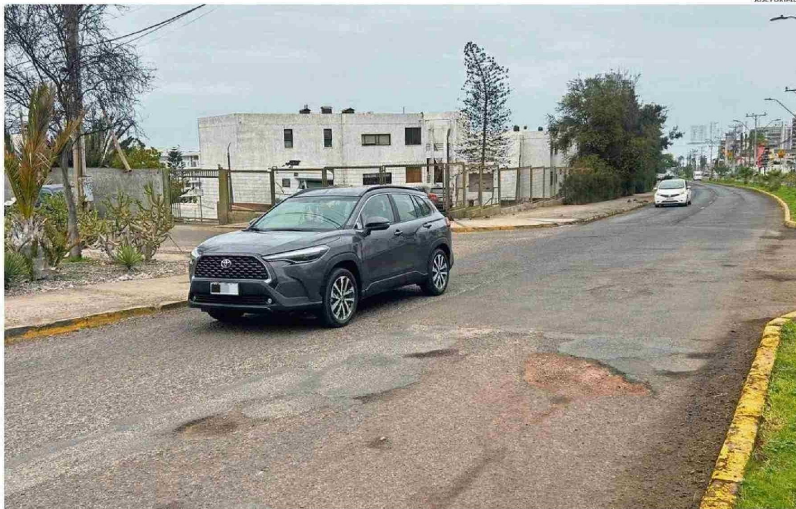
ACUSAN QUE EL ABANDONO DE LA AVENIDA FRANCISCO BILBAO NO ES UNA DEMANDA NUEVA Y ASEGURAN QUE LA ARTERIA HA IDO EMPEORANDO.
