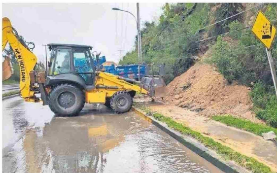
En Chiguayante se dio un deslizamiento de tierra que obstruyó la ruta en Villuco.
