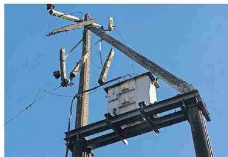
El daño en el transformador pareciera no notarse, pero en el poste sí.
