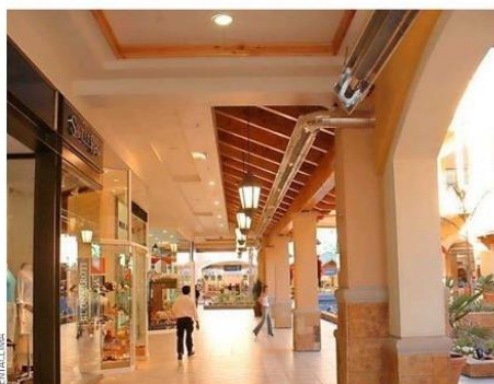
Sistema de calefacción radiante infrarroja más grande de Sudamérica, implementado en el Mall Portal la Dehesa de Cencosud.
