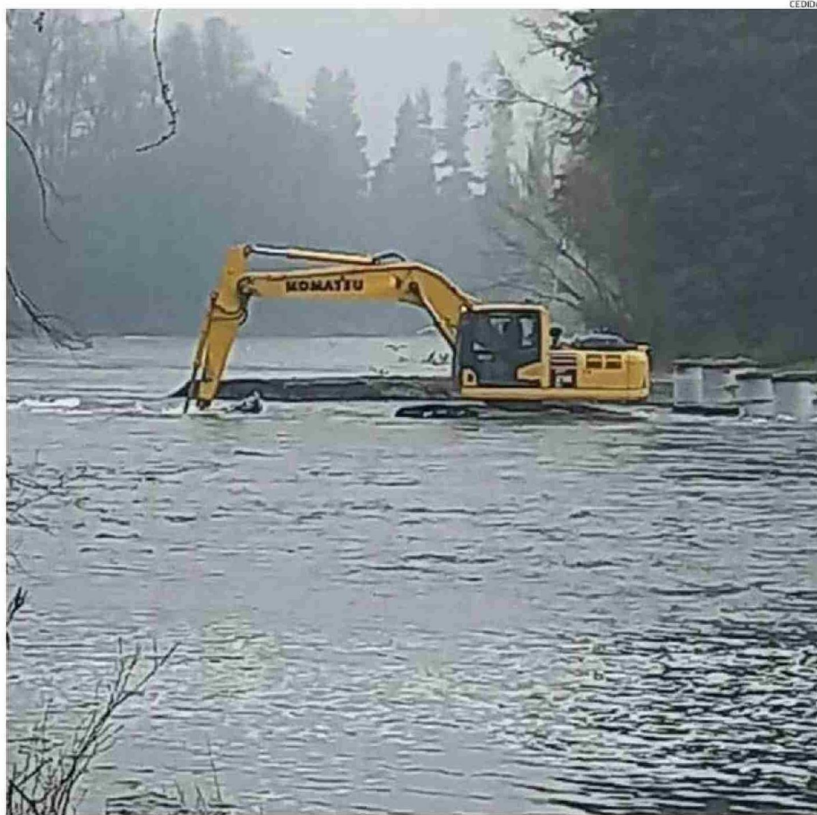
LA MÁQUINA FUE DETECTADA EN PLENA FAENA DENTRO DEL RÍO Y ESTAS IMÁGENES SE PRESENTARON COMO PRUEBA A LA DGA.
