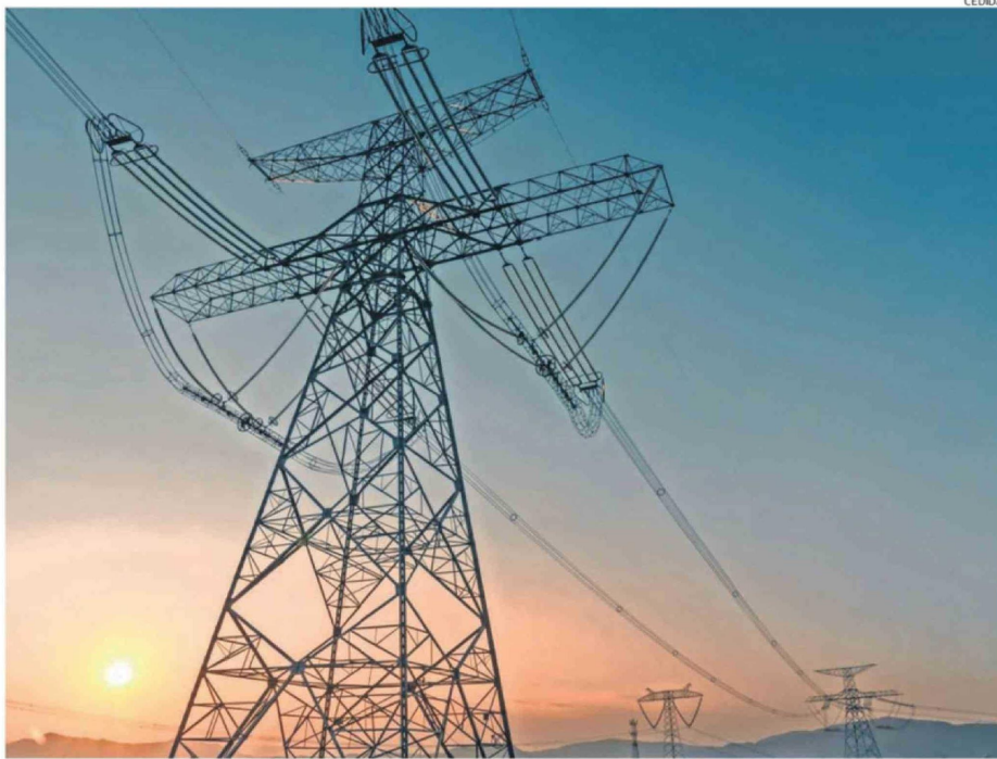
UNO DE LOS PROYECTOS ES LA LÍNEA DE TRANSMISIÓN ELÉCTRICA HVDC KIMAL-LO AGUIRRE, CON UN MONTO ESTIMADO DE US$ 1.480 MILLONES.
