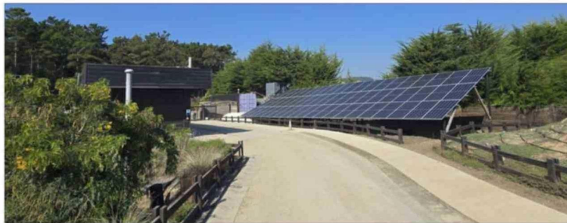
Los 60 paneles solares aportan parte de la energía que requiere el sistema.
