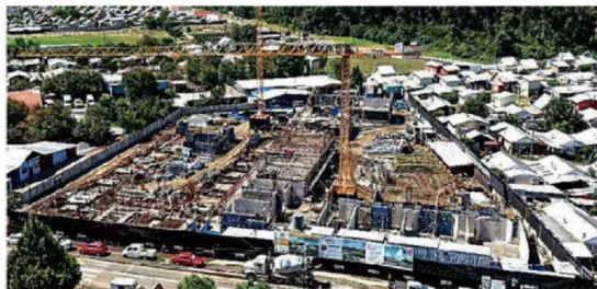
Las obras tienen un avance de 23,81% al 28 de abril de este año.
