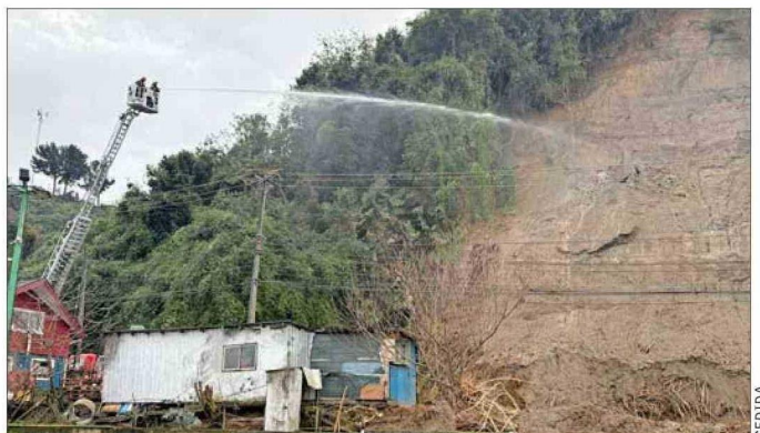
En Puerto Montt, bomberos con lanzagua contribuyeron a "lavar" el cerro para facilitar el retiro de material suelto que sigue cayendo.
