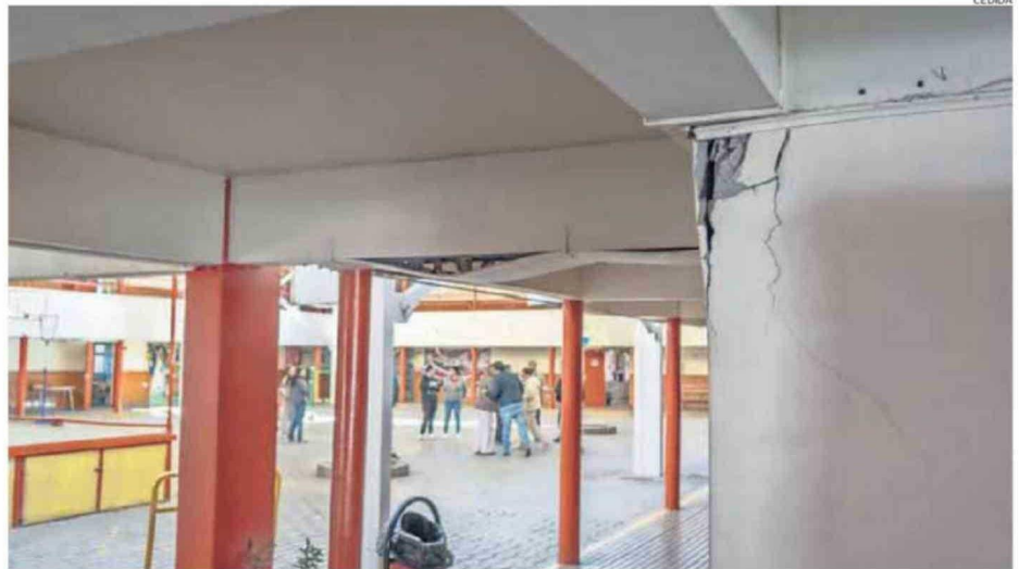
LA ESCUELA VALENTÍN LETELIER FUE UNA DE LAS AFECTADAS EN SU INFRAESTRUCTURA TRAS EL TERREMOTO DEL PASADO LUNES EN CALAMA.
