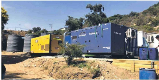
El informe reitera la falta de pretil de contención antiderrames para el combustible del grupo generador, situación que ya había sido observada y no fue corregida.
