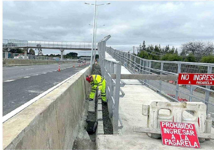
EL ACCESO A LA PASARELA EN EL SECTOR LA GOLETA PERMANECE CERRADO, SUBRAYARON DESDE LA DGC.
