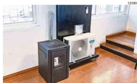
EL PROGRAMA HA PERMITIDO LA INSTALACIÓN DE 11.464 EQUIPOS.
