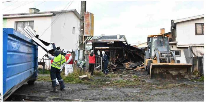
La DOM intervino la propiedad en calle Mardones ante la falta de dueños responsables, priorizando la seguridad del entorno y la eliminación de focos de insalubridad.
