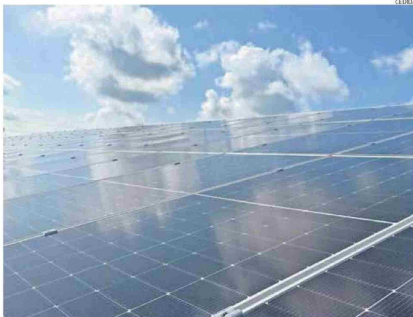
LOS DURMIENTES SE TRATA DEL PRIMER PROYECTO DE RWE APROBADO AMBIENTALMENTE EN CHILE.
