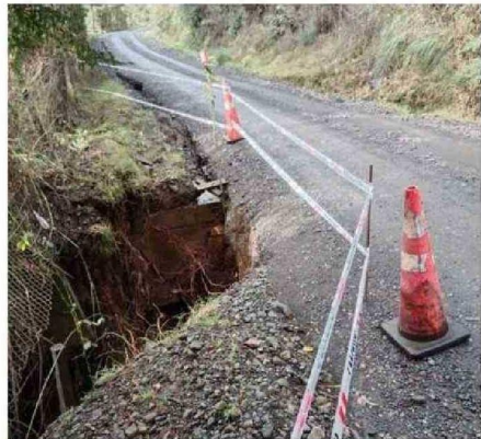
LA SEÑALIZACIÓN AVISA DE ZANJAS QUE VAN CONSUMIENDO LA HUELLA.
