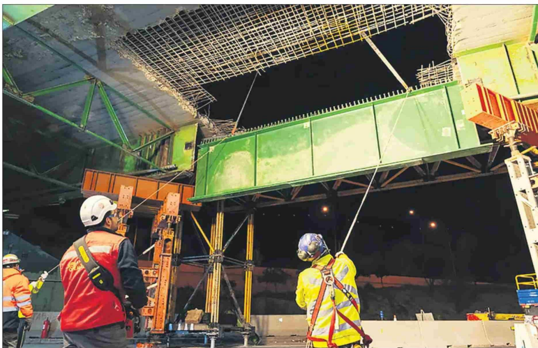
Vista inferior en que se aprecia el recorte de la losa que ahora hay que reponer. Mide 10 por 7 metros.
