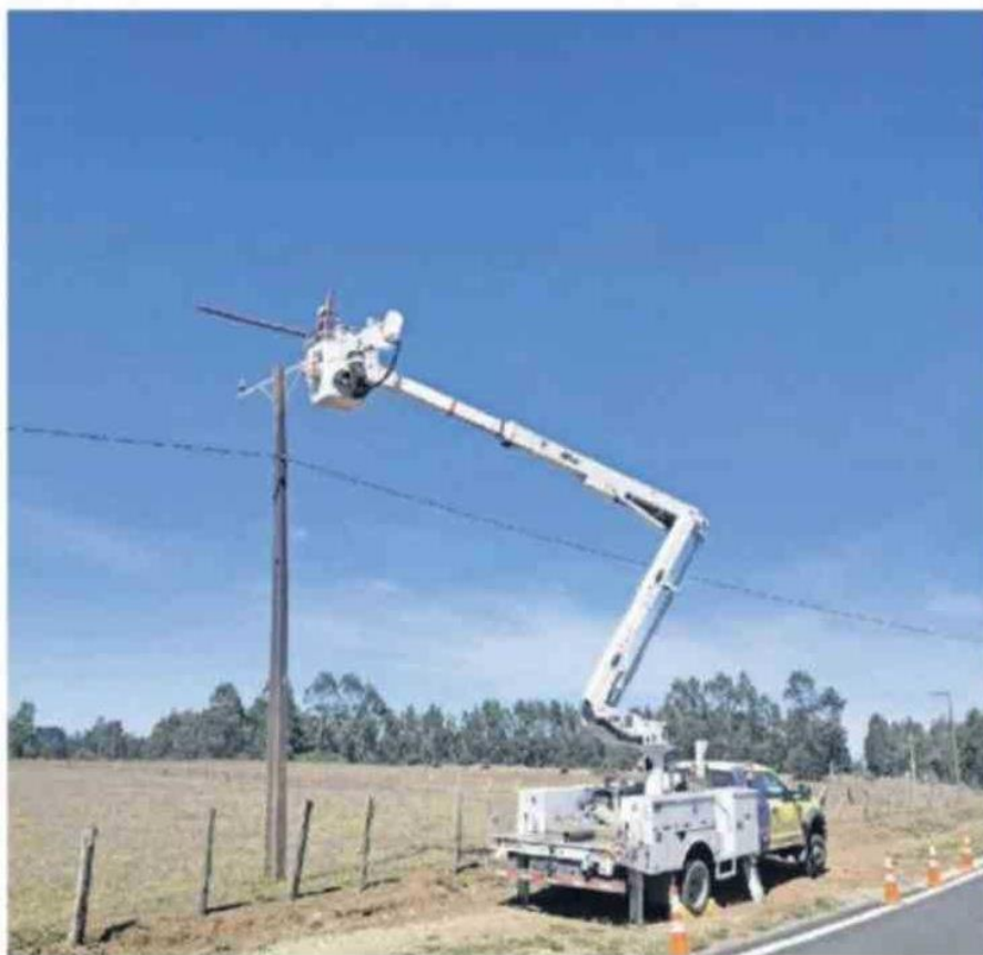
El plan incluyó fortalecimiento de estructuras eléctricas.
