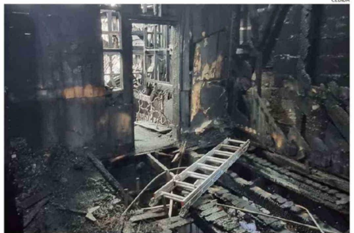
ASÍ LUCE HOY POR DENTRO EL TABLÓN DEL ANCLA. LOS DAÑOS SON TOTALES.
