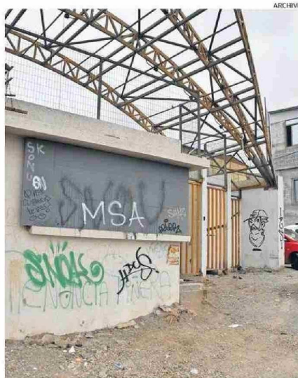
DESDE EL 2019, LA OBRA FUE SISTEMÁTICAMENTE VANDALIZADA.
