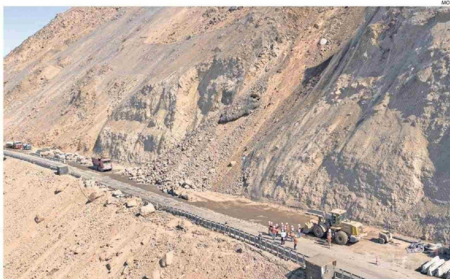
LA MAGNITUD DE LOS RODADOS HA IMPEDIDO LA NORMAL CIRCULACIÓN DE VEHÍCULOS DE ARICA HACIA EL SUR.
