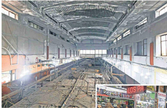
Sobre los locales es posible ver suciedad. Comerciantes igual están inquietos por el sistema eléctrico.
