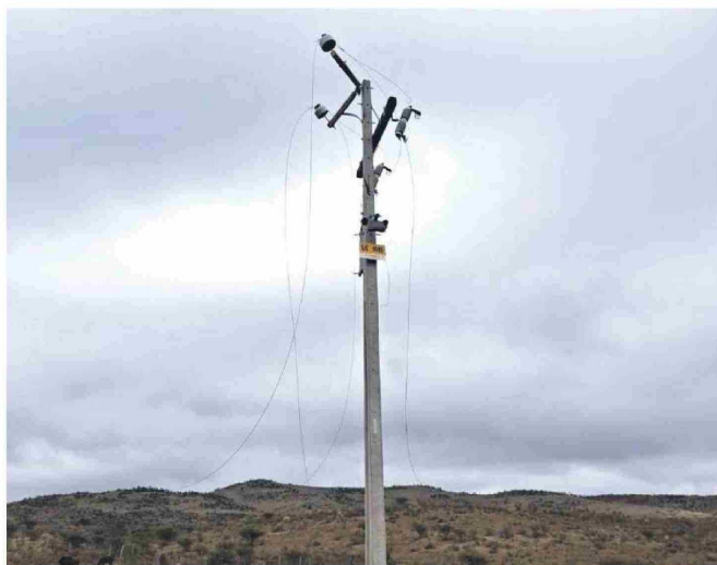
Casi 2 kilómetros de cable de cobre fueron robados en la comuna de Ovalle.
