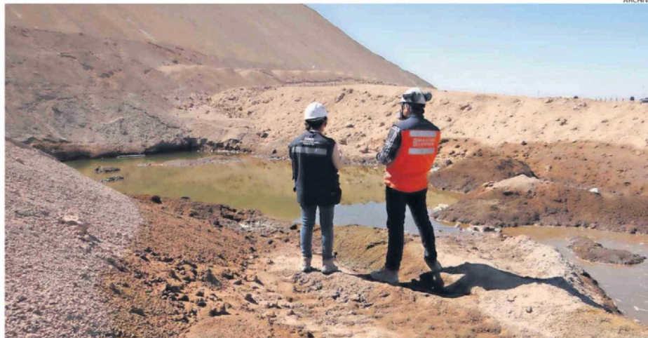
LAS FILTRACIONES EN LA AUTOPISTA A LA ALTURA DEL KILÓMETRO 1.405 COMENZARON A EVIDENCIARSE EN EL AÑO 2020.
