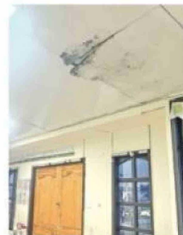
Esta fotografía muestra una falencia del techo y cielorraso del Centro de Recursos del Aprendizaje de la escuela básica fueguina, por donde ingresaron aguas lluvias que inundaron ese espacio de estudios.
