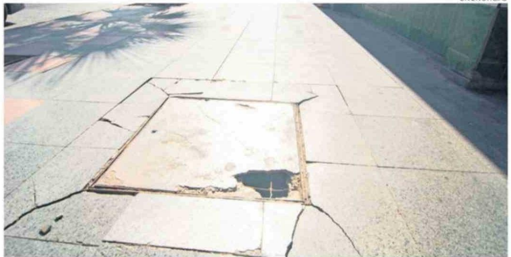
EL ESTADO DE ALGUNAS VEREDAS SIGUE EVIDENCIANDO PROBLEMAS DE ACCESIBILIDAD Y SEGURIDAD.
