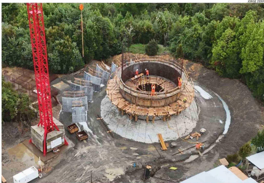
ACTUALMENTE SE CONSTRUYE LA COPA DE 25 METROS DE ALTURA, QUE ALMACENARÁ 200 MIL METROS CÚBICOS DE AGUA POTABLE.
