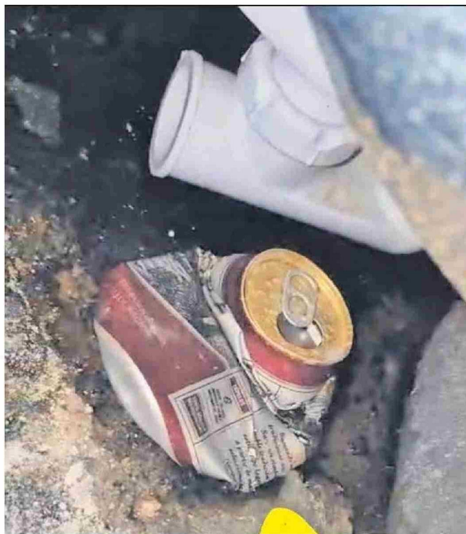
LOS VECINOS HAN ENCONTRADO LATAS SOPORTANDO INFRESTRUCTURA SANITARIA.
