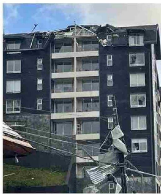
EDIFICIOS Y VEHÍCULOS FUERON DAÑADOS.
