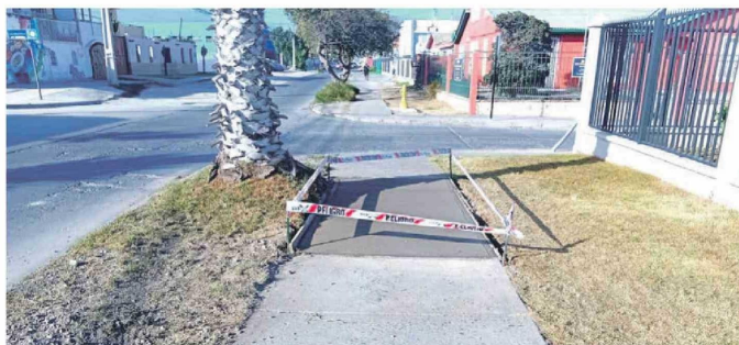
EL DÍA El municipio de Coquimbo está reparando las veredas en el sector de Sindempart donde están deterioradas, levantadas por las raíces de los árboles o por sismos.
