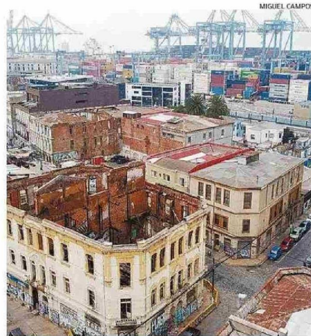
EL DETERIORADO ESTADO DEL BARRIO PUERTO GENERA INQUIETUD.
