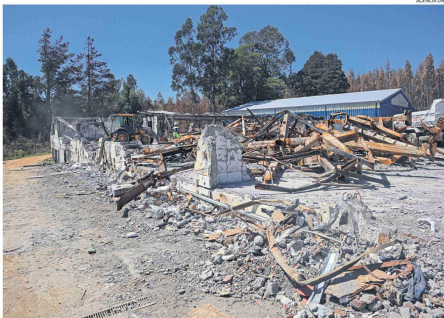
ESCUELA PUNTA DE PARRA FUE UNA DE LAS ESTRUCTURAS DESTRUIDAS POR EL INCENDIO DE ENERO.
