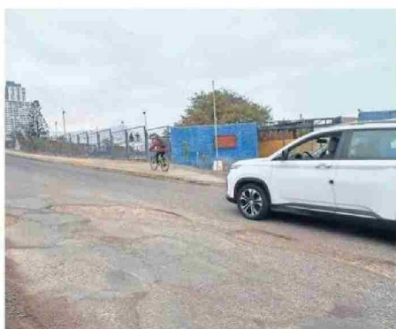
LA CALZADA ES UNA AMENAZA PARA CONDUCTORES.
