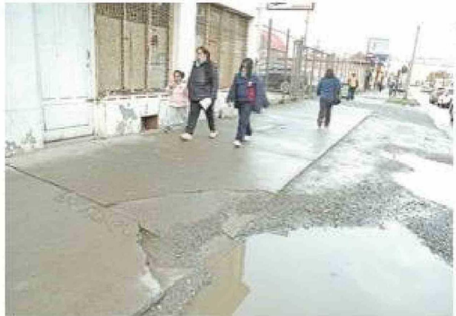
El deterioro de la acera en Ignacio Carrera Pinto, lado norte, al llegar a calle Magallanes, genera preocupación entre peatones y locatarios por los riesgos ante la llegada del invierno.
