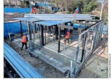
DECISIÓN.— La medida no fue tramitada ante la Dirección de Obras, pues son obras no recepcionadas.
