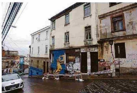
EL MUNICIPIO ACORDONÓ EL SECTOR PARA EVITAR EL TRÁNSITO PEATONAL.
