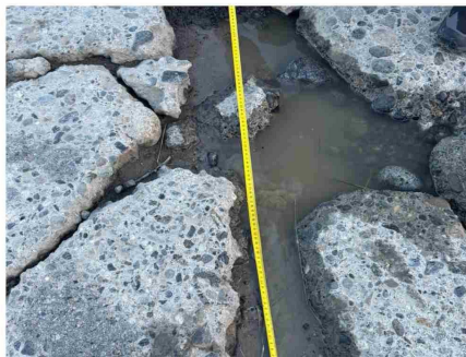
Baches de hasta 12 centímetros de profundidad.
